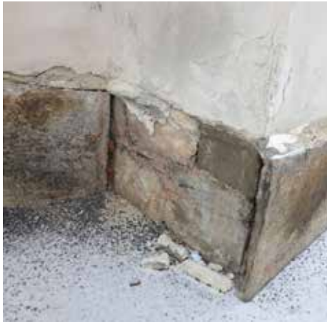
Die Außenfassade bröckelt
